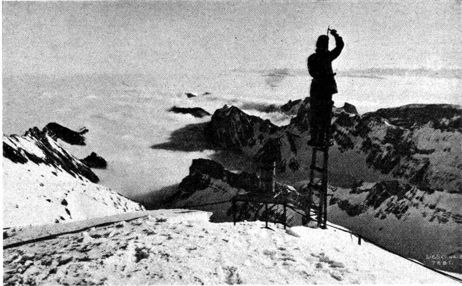
Don der Wetterwarte auf dem Säntis: Bei der Blitzableiter-Reparatur. Phot. S. Hablützel, Zürich.
