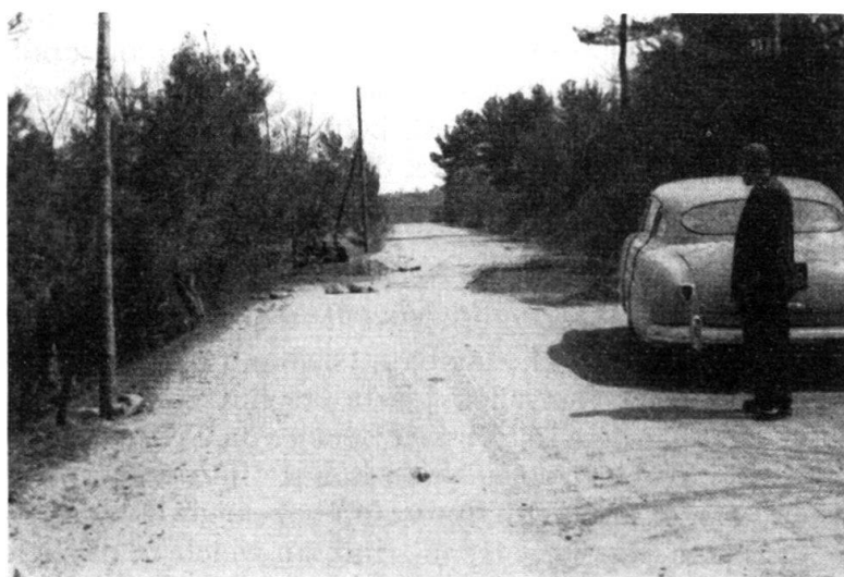
Fig. 10. Verschneidung der Hauptstrasse Bahkesir-Çanakkale im E von Yenice zwischen km 107 und 108 (etwa 200 m östlich km 108). Verschiebungsbetrag mindestens 2,5 m (spitzwinklige Verschneidung). Blick gegen E.
