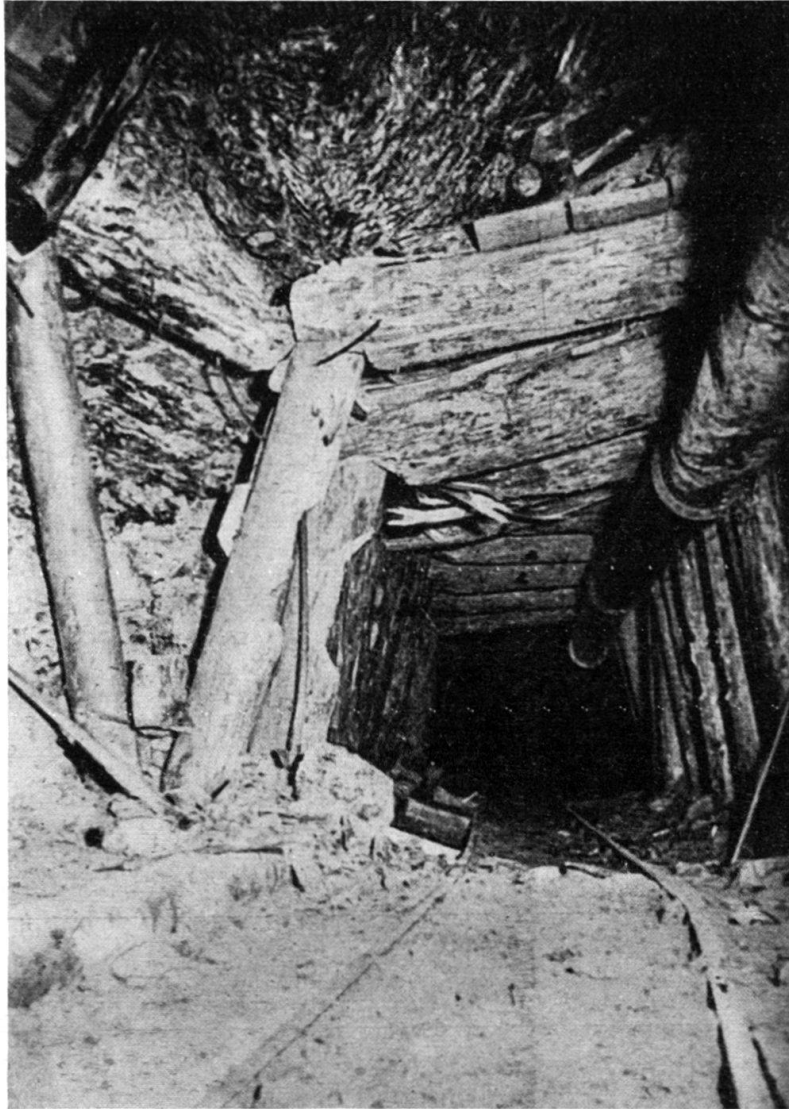
Fig. 1. Stollen Valatsch-Wanna bei 1108 m. Im mylonitisierten Kalkglimmerschiefer, der tektonisch eingepressten Gips enthält, hat sich über dem linken Parament aus der ursprünglich flach nach links einfallenden Schicht eine Falte gegen den Stollenhohlraum vorgestülpt und drückt nun auf die Zimmerung. Bildung der Falte innerhalb einiger Tage
