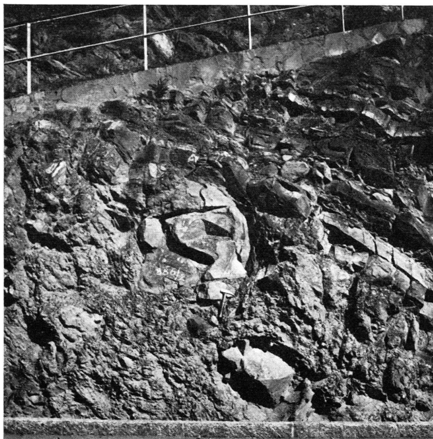
Fig. 6. Bifurcation des routes des Mosses et du Pillon (Vaud). Flysch conglomératique basal de la nappe du Niesen, maestrichtien. La série est renversée. Elle consiste en un sommet de multistrat à laminites (moitié supérieure de la photo) et en une base conglomératique très grossière de la multistrat suivante.
