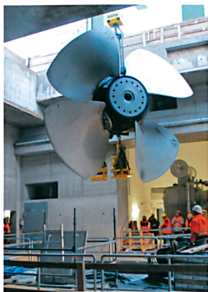
Das Einheben des Laufwerks für die Turbine erforderte millimetergenaues Arbeiten: Es wiegt 60 Tonnen und wurde in einem Stück angeliefert.
