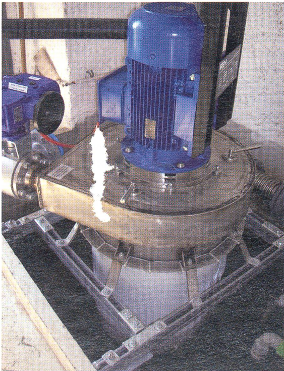
Das Kleinwasserkraftwerk wurde von der Firma OFATEC im Trinkwassertank von Auvernier installiert.
