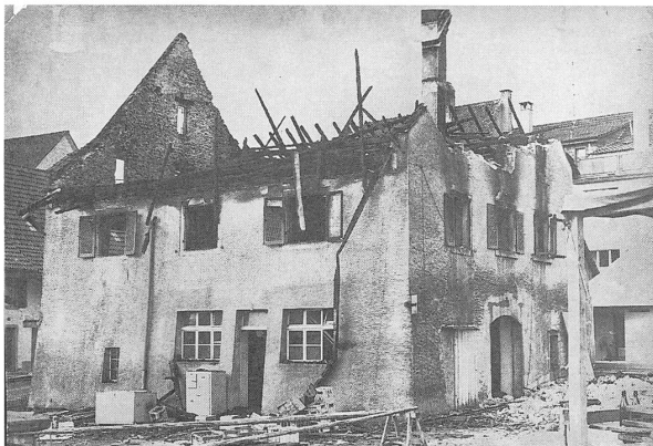
Brandruine der Trotte auf dem Widenplatz, abgebrannt am 26. Juli 1970.
