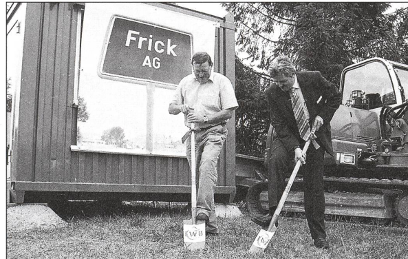
Spatenstich als Startschuss ins Erdgas-Zeitalter mit Gemeindeammann Anton Möschi (links) und Heinrich Schwendener von den Industriellen Werken Basel.
