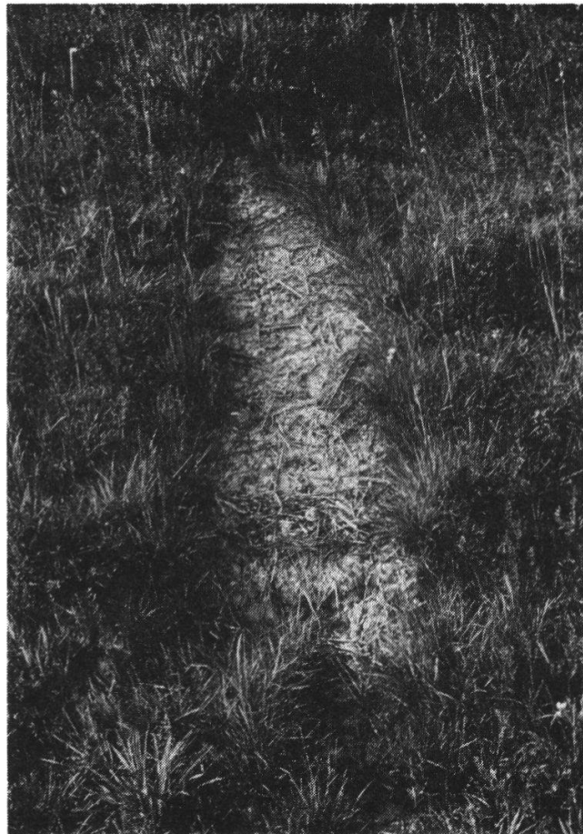
Abb. 14. Ständig feuchte Stelle auf der Böschung Wagenhausen. Eine undurchlässige tieferliegende Bodenschicht bewirkt, dass ständig Wasser austritt, was Pflanzenwuchs praktisch verunmöglicht.
