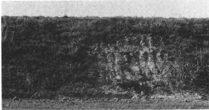
Abb. 15. Abgerutschtes Böschungsstück bei Wagenhausen. Die Vegetation an dieser Stelle war relativ dicht. Das abgerutschte Material ist bereits wieder auf die Böschung gebracht worden.
