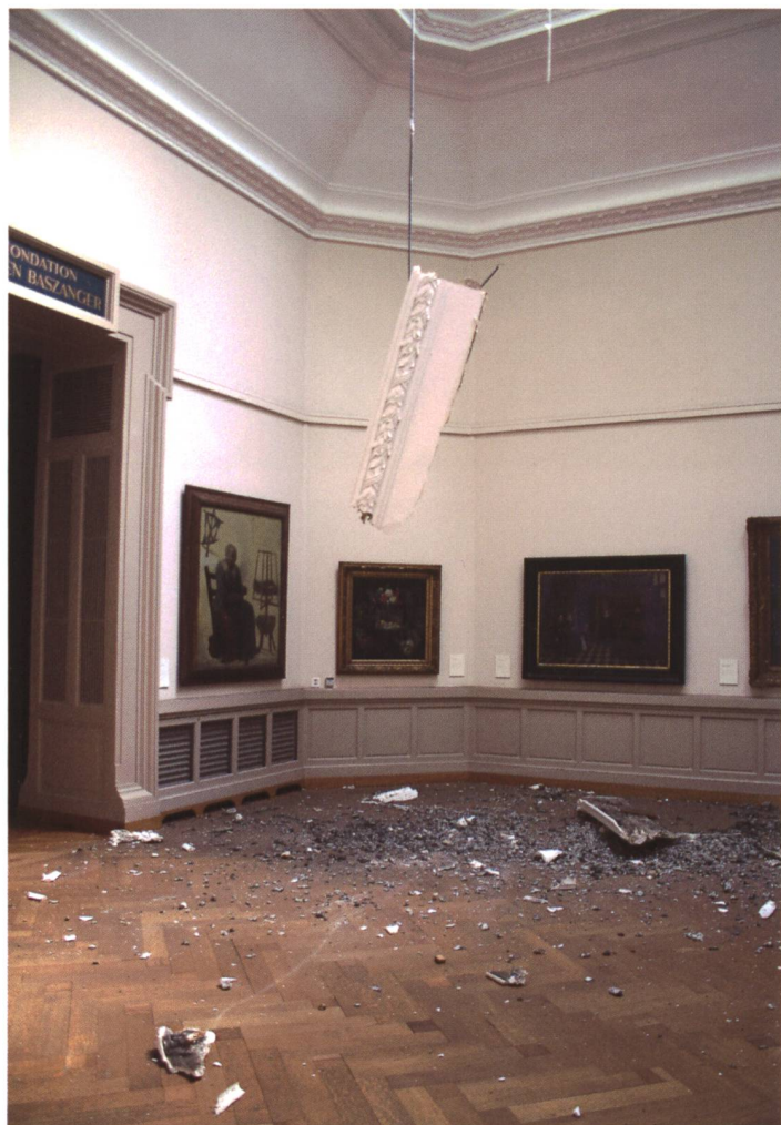
3 Au nombre des dégâts survenus ces dernières années au musée, la chute de ce pan de corniche au mois d'août 2007 est certainement l'un des plus spectaculaires.
