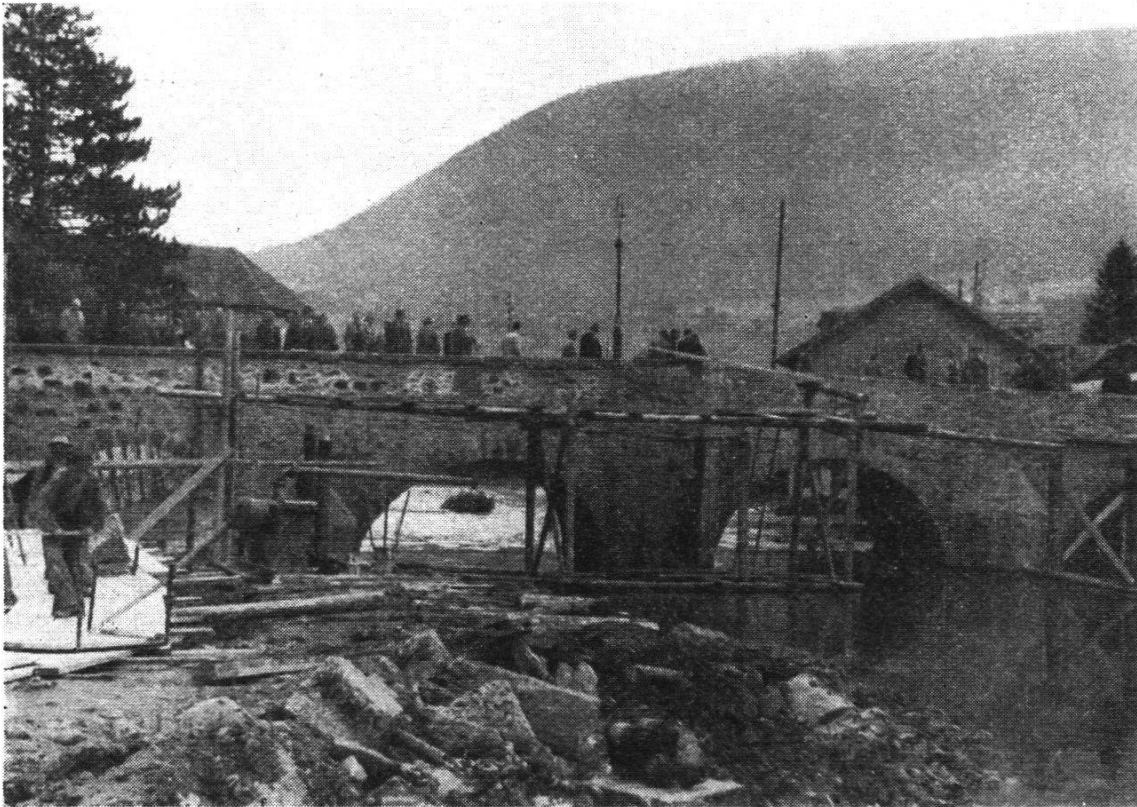
Korrektion der Areuse. Alte, durch Injektionen und Unterfangung zu erhaltende Areuse-Brücke in Travers.
