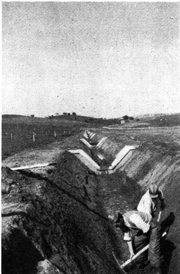
Bild 1. Bei Valpiano südlich Massa Marittima, Erdkanäle mit Abstürzen ohne Tosenbecken
