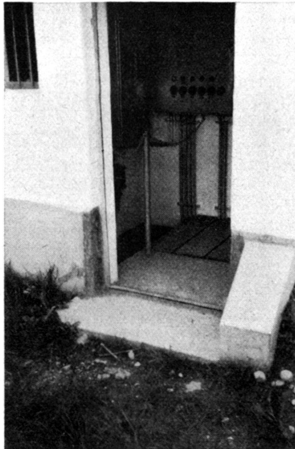
Abb. 5. Pumpstation mit Steuer- und Zählertableau
