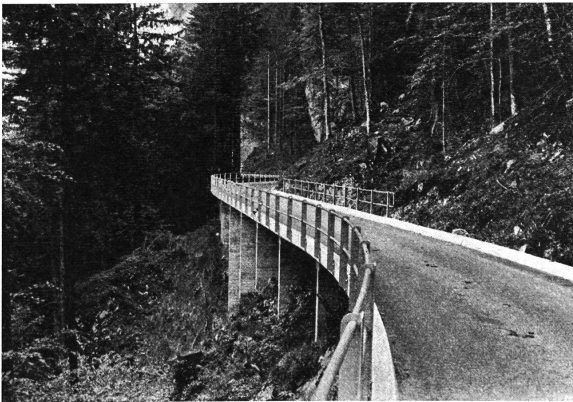
Bild 5: Fertiger Lehnenviadukt, Stützwände verschieden hoch. Es sind drei Plattenelementtypen verwendet worden. R = 60 m
