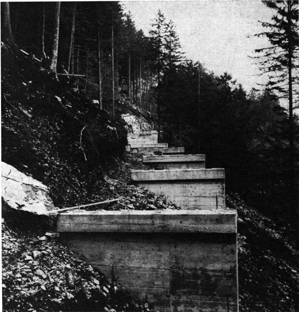
Bild 1: An Ort und Stelle vorbereitete und betonierte Stützwände mit Auflagerkopf zur Aufnahme der Plattenelemente
