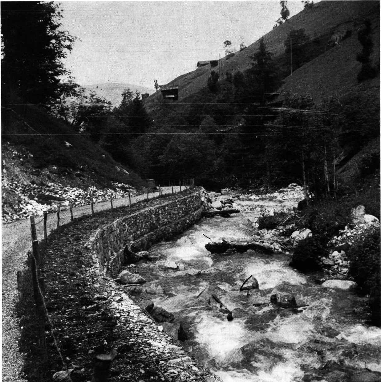
Abb. 9 AVI-Steinkorbbauweise als Bach- und Wegverbauung kombiniert
