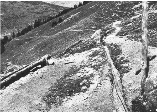
Abb. 8 Die eingelegte Versuchsleitung (Kaliber 11 mm) mit Telefonkabel vor dem Eindecken des Grabens. Leitung von St. Martin
