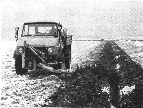
Abb. 8 Verfüllschnecke «Hoes» an Unimog. Verfüllen eines gefrästen, 28 cm breiten Grabens (sandiger Lehm). Baujahr 1971; Gewicht 380 kp (ohne Unimog); Schneckenlänge 1250 mm; Auslegerlänge (von Fahrzeugaußenkante); linksfördernd 1600 mm, rechtsfördernd 2100 mm; Arbeitsgeschwindigkeit bis 3 km/h. Anschaffungspreis: Unimog 60000.-, Schnecke 15000.-.
