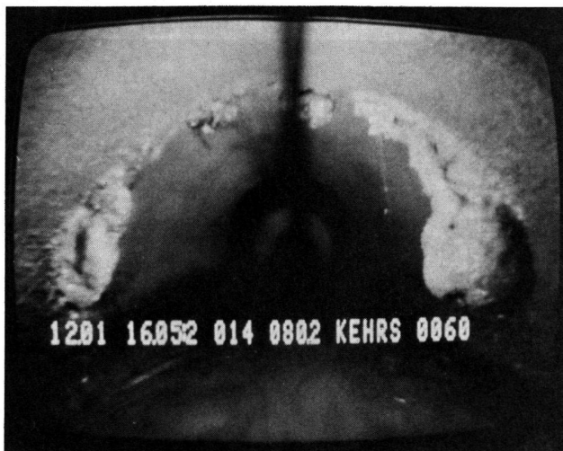
Abb. 1 Ausscheidungen bei undichten Rohrfugen. Die dunklen Schatten stammen von der Kameralhalterung.
