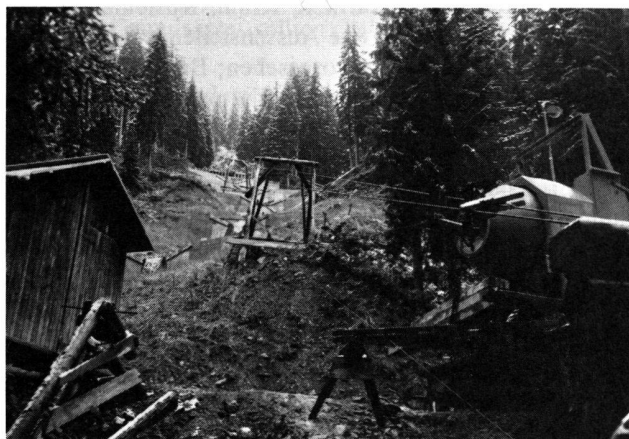
Abb. 2 Typische Wildbachbetonbaustelle auf 1400 m im Mödritschbach bei Irschen im Drautal ( E = 7,7 \text{ km}^2 , Talzuschubprobleme): Links Arbeiterlager, rechts Betonmischer mit dem Beginn der Seilbahn, welche den Beton zur eigentlichen Baustelle hinaufbefördert.
