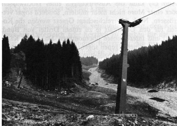
Abb. 16 Auf der breiten Waldschneise der V 73 findet eine starke Flächenerosion statt. Auch die neu herangeführten Humushaufen dürften beim nächsten Starkregen mit viel Wasser und Geschiebe wieder zu Tal befördert werden . . .
