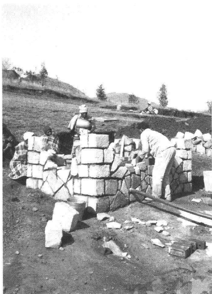
Abb. 2: Lesotho, «Village Water Supply»; Eigenleistungen beim Bau sind entscheidend für die Akzeptanz von Infrastrukturen. Das Programm wird durch die Helvetas in Regie durchgeführt. (Foto: G. Roth, Bern.)
