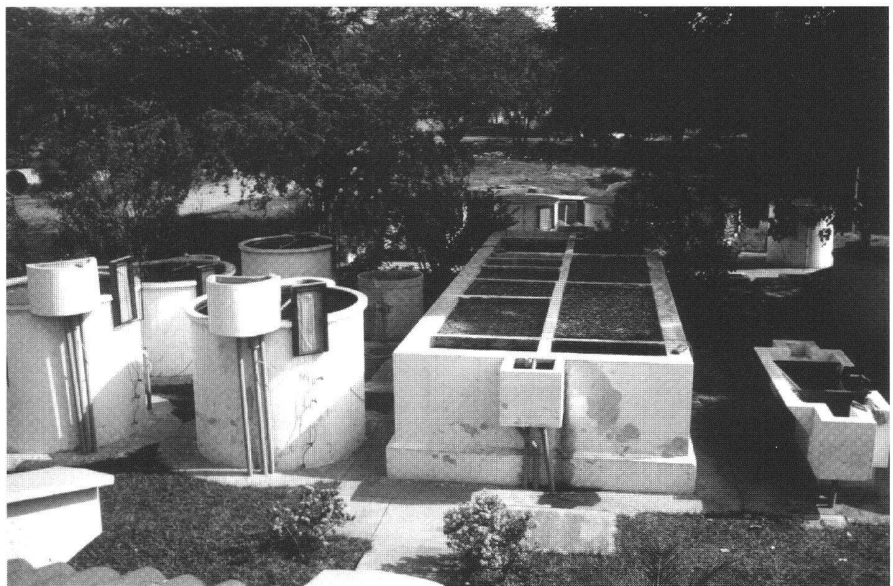
Abb. 2: Aufbereitungslinien der Versuchsstation von Cinara (vertikal und horizontal durchflossene Kiesfilter).
