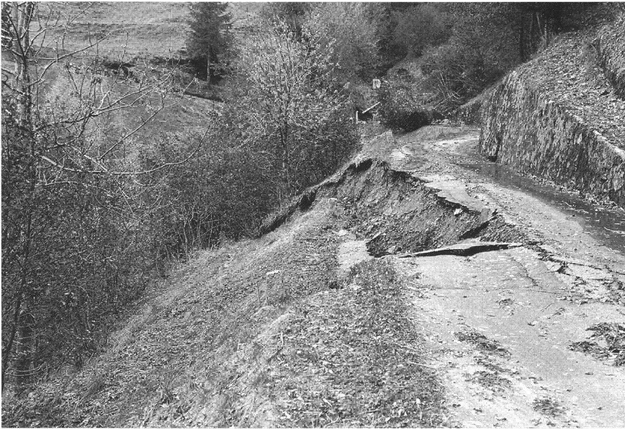
Abb. 1: Unwetterschäden 93, Campo Blenio (TI), Güterweg bei Pianchera. Die Unwetterschäden in den Kantonen TI und VS wurden 1994 mit Hilfe von Sonderkrediten grösstenteils behoben. (Photo: M. Giamboni, studio tecn. d'arch. Imperatori e Giamboni SA, 6715 Dongio.)
