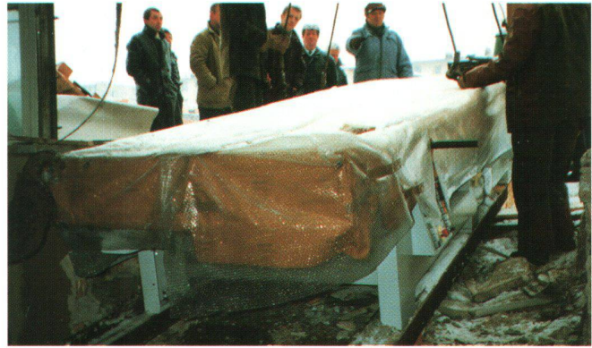
Abb. 14: Ein zwei Tonnen schwerer Druckmaschinen-Teil auf dem Weg durch die herausgebrochene Hauswand in den Druckraum.
