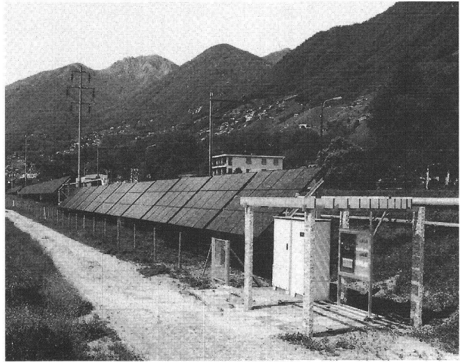
Abb. 4: Photovoltaik-Netzverbundanlage entlang der SBB-Linie Bellinzona-Locarno.
