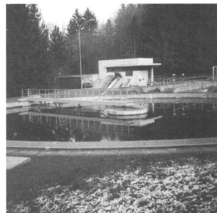
Abb. 1: ARA-Münsingen: Nutzung der Abwärme.
