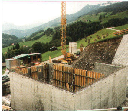
Abb. 7: Das Reservoir Eggli im Bau (Foto: LANA des Kantons Bern, Abt. Strukturverbesserungen).
