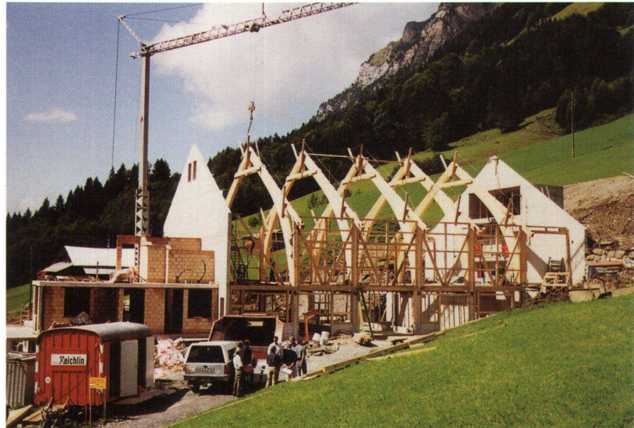
Abb. 8: Kurz vor dem Aufrichten der Scheune im September 2000. Die Schneelast und der Lawinenschutz erfordern eine massive Konstruktion (Foto: P. Klaus, ASV/BLW).
