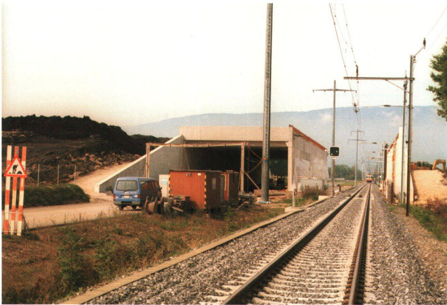
Abb. 1: Wildüberführung Islerenhölzli in Gampelen über T10 und Bahn im Bau. Kombinierte Ökomassnahme beim Bau der Umfahrung Ins-Gampelen. Die Aufschüttung für die Wild-Querung besteht aus schwermetallverseuchtem Bodenmaterial.
