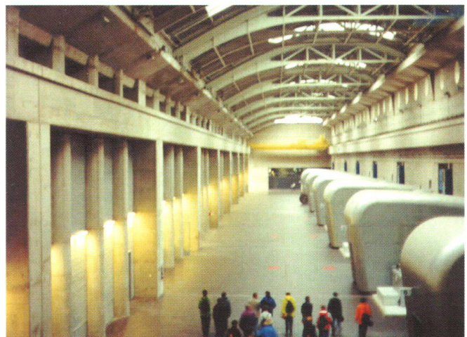
Abb. 2: Maschinenhalle des Kraftwerkes Freudenau (Foto: U. Meier).
