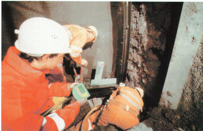
Einbau eines Stahlbogens im Lockergesteinsvortrieb. TMS SET-OUT PLUS im Einsatz durch die Vortriebsmannschaft.
