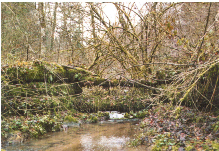
Abb. 2: Offene Sperre am Stutzgraben bei Osterfingen (Kanton Schaffhausen) bei Normalwasser. Durch die offene Holzsperrre kann der Bach feineres Geschiebe weitertransportieren, wodurch eine minimale Bachdynamik möglich ist. Zudem ist die offene Sperre für aufwandernde Tiere passierbar.
