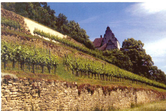
Abb. 1: Trockenmauer beim Schloss Castelen/Schenkenbergertal (AG). Die Wiederinstandstellung von Trockenmauern kann künftig bei Strukturverbesserungen subventioniert werden. (Foto: Christoph Flory, Ennetbaden.)
