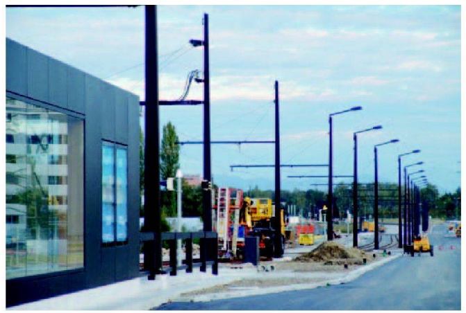
Abb. 6: Einheitliche Gestaltung der Fahrleitungs- und Beleuchtungsmasten.
