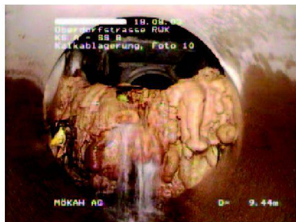
Abb. 3: Ein kräftig verockertes Sammlerrohr.
