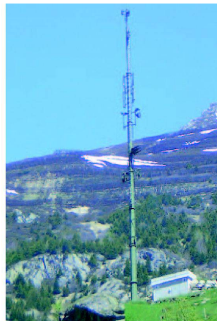
Das Sendernetz der SRG SSR idée suisse besteht aus über 1000 Senderanlagen. Sie werden laufend optimiert.
