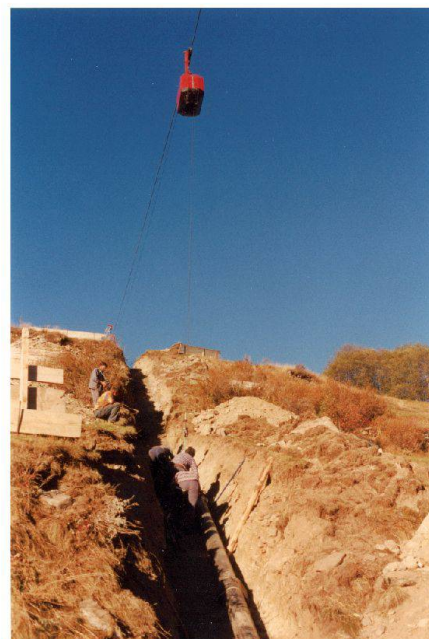
Abb. 5: Druckleitung und Abwasserleitung Guarda–ARA mit Transportseilbahn.
