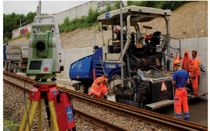
Abb. 4: 3D-Steuerung Einbaumaschine mit Totalstation. Fig. 4: Pilotage 3D d'une machine de pose de revêtement avec station totale. Fig. 4: Comando 3D di una macchina di posa con stazione totale.
