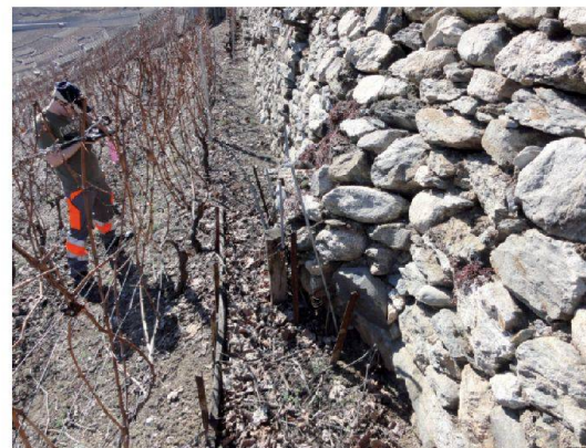
Fig. 1: Relevé d'un dégât présentant un parement bombé.
