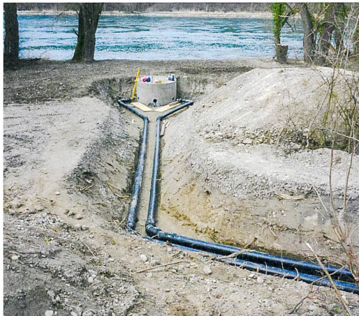
Abb. 15: Bewässerungspumpwerk, Pumpenschacht mit angeschlossenen Druckleitungen.
