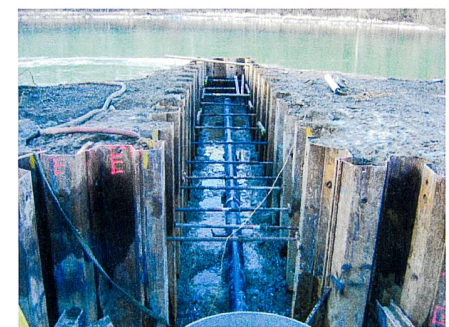
Abb. 14: Bewässerungspumpwerk, Zubringerleitung aus dem Rhein.
