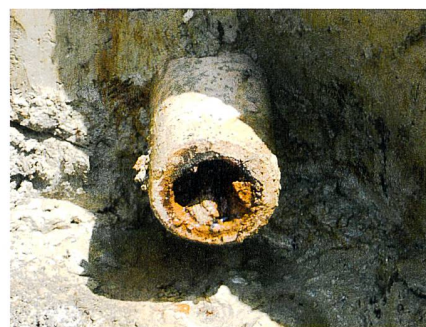
Abb. 12: Alte Saugleitung (Ton), teilweise verstopft.
