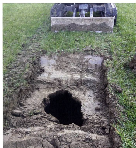
Abb. 2: Erdloch über einer Drainage, entstanden durch langjährige Ausspülung (Foto MGR).
