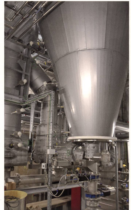
Abb. 4: Der untere Teil des Schwebebettreaktors. Hier werden Fremdstoffe (Nägel, Schrauben, Steine usw.) durch die Schwerkraft nach unten abgeschieden.
