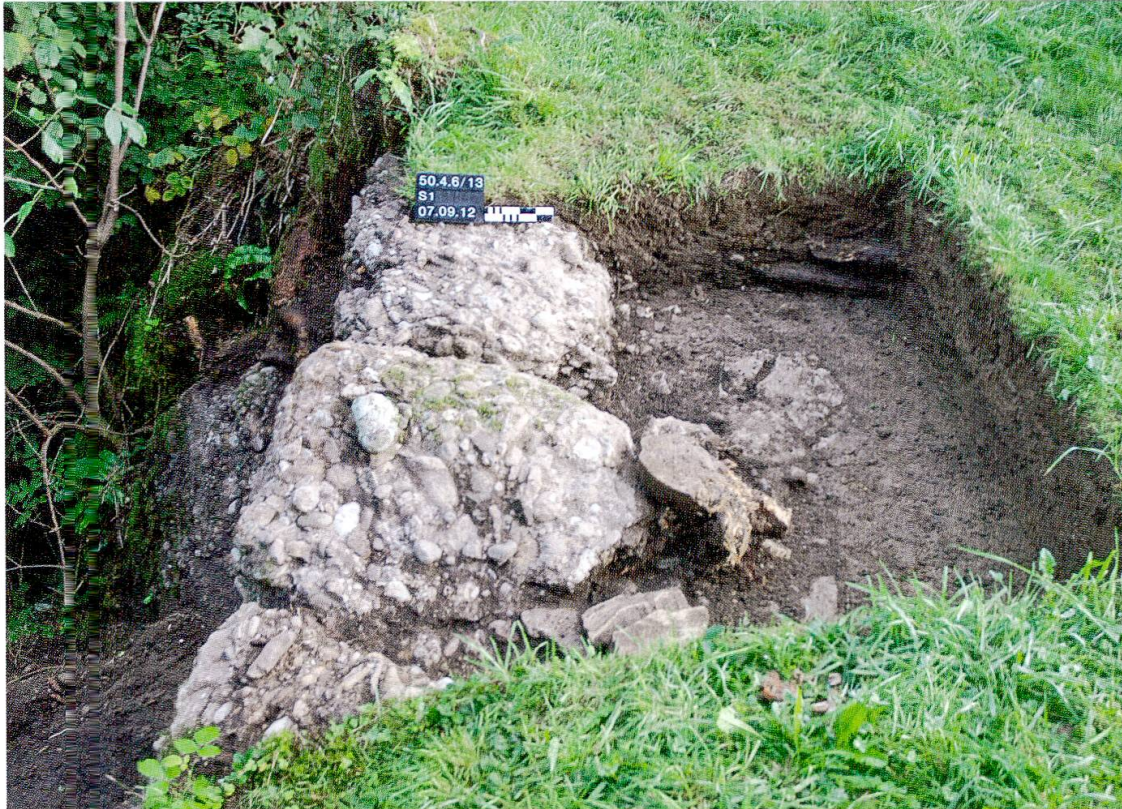
Abb. 3: Schnitt S1, Blick auf die Mauerkrone der einhäutig aufgeführten Stützmauer, von SW.
