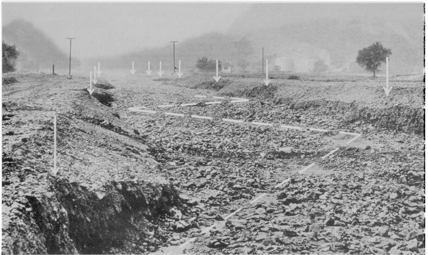
Fig. 23 Trockenes Gerinne eines Wildbaches in kanalisierter «Flachstrecke» mit ungeschützten Ufern, kurz nach einem rasch durchlaufenen und sehr schnell abgeklungenen Hochwasser. Man beachte die rhythmische Anordnung der Uferangriffsstellen (Pfeile) und entsprechende Spuren auf der Gerinnesohle (im Vordergrund befindet sich quer dazu eine Bulldozerspurr). Los Angeles County, Feb. 1962 ( J_s = einige Prozente Wassertiefe \leq 0,5 m).
