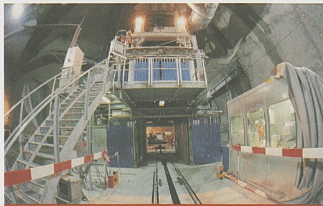
Die «Talstation» der gewaltigen Schachtförderanlage befindet sich 800 m «unter Tag».
