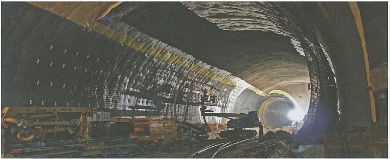
Multifunktionsstelle: Spurwechsel zur Weströhre.
