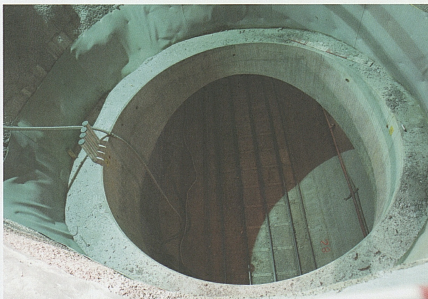
Faido: Abluftschacht mit Blick in die Weströhre.
