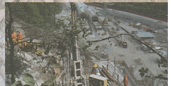
Vista sui due tubi della galleria artificiale e sul rilevato per lo spostamento della strada cantonale (a destra nella foto).
