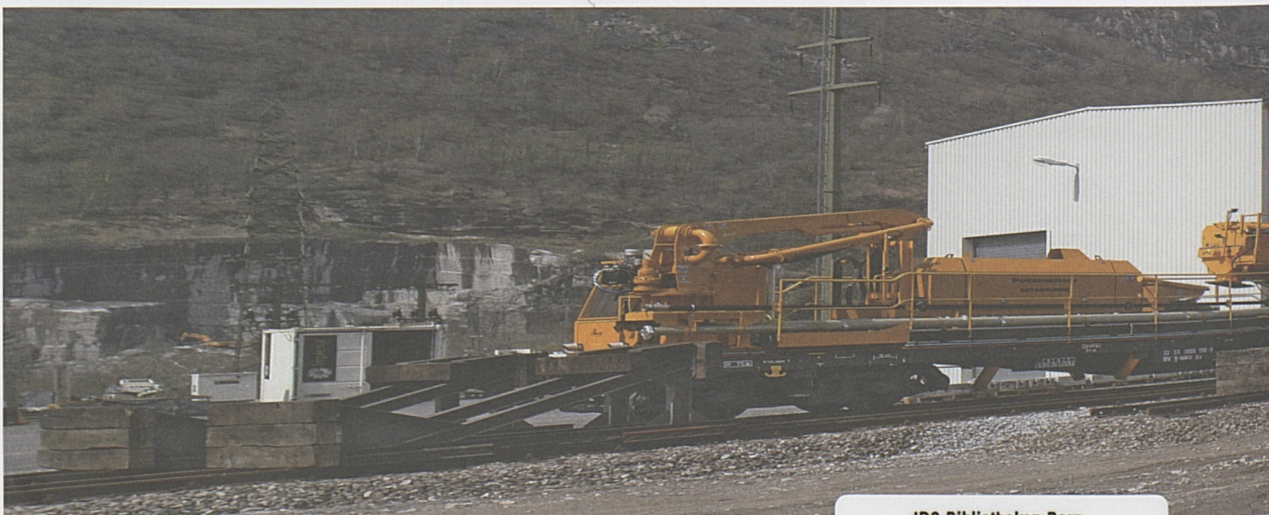
Il treno speciale che permetterà di produrre (e posare) il calcestruzzo della platea direttamente in galleria.
