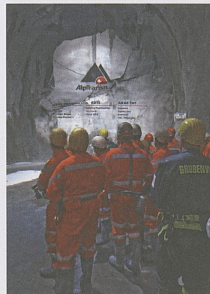
Le prime fessure nel fronte di scavo.
