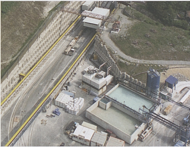
Die Verschmutzungen im Bergwasser werden in grossen Becken abgesetzt und aufbereitet.
