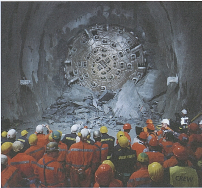
Kurz nach dem Durchbruch: Der glänzende Bohrkopf stösst die letzten Felsblöcke aus dem Weg.
